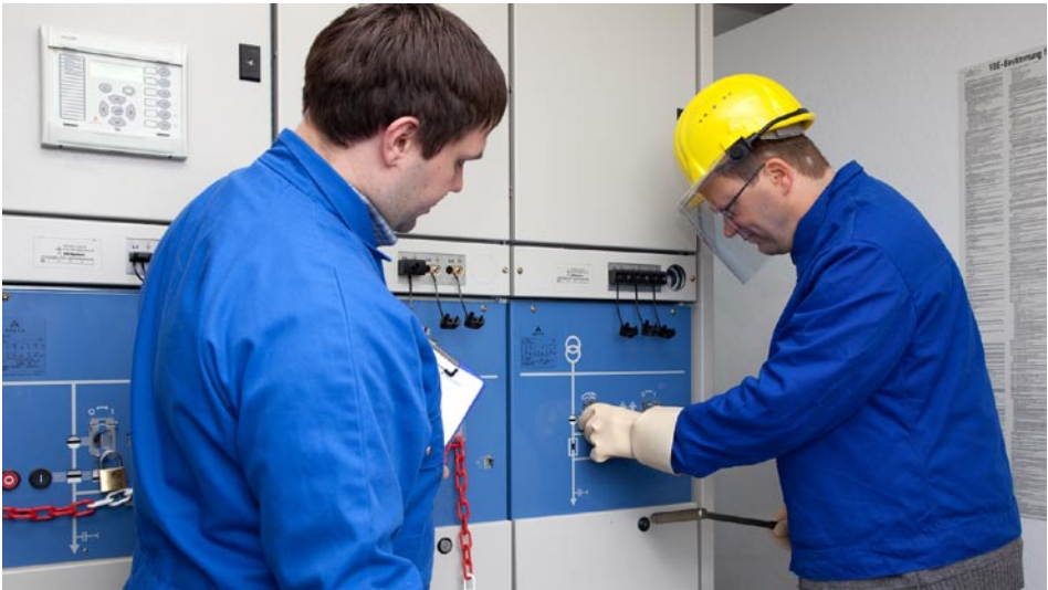
Bild 10: Schalteinrichtungen im Forschungs- und Prüflabor zur Netzintegration (PNI) im SysTec
